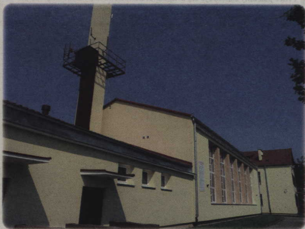
W tym roku zakończy się termomodernizacja budynku, w którym mieści się Szkoła Podstawowa w Janowie. Trwają przygotowania do dokończenia docieplenia obiektu.
