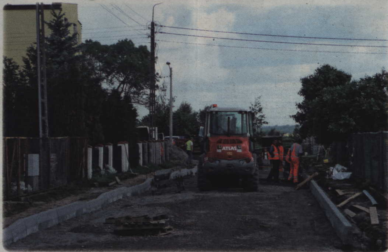
Trwa budowa dróg osiedlowych w Marezie. Prace prowadzone są na ulicach Osiedlowej i Ogrodowej.
