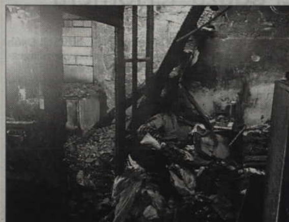
Na 150 tys. zł oszacowano wstępnie straty związane z pożarem wielorodzinnego budynku mieszkalnego w Starym Kamieniu.
