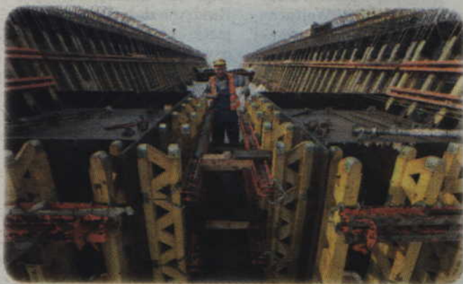
Konstrukcja typu extradosed (z ang. Extradosed prestressed bridge) będzie największą tego typu w Europie i jedną z największych na świecie.
