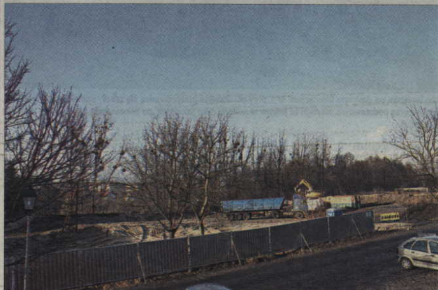
W Górkach trwa obecnie przygotowanie placu na którym staną obiekty parku. Pogoda sprzyja wykonawcy.
