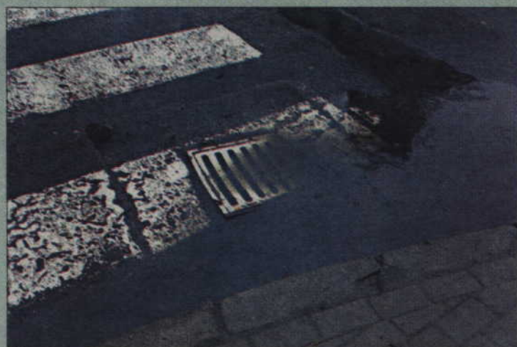
Nie ma mowy, by w pobliżu dystrybutora paliwa znalazła się taka studzienka kanalizacyjna. Odpływ wód deszczowych musi być wyposażony w czynny separator.
