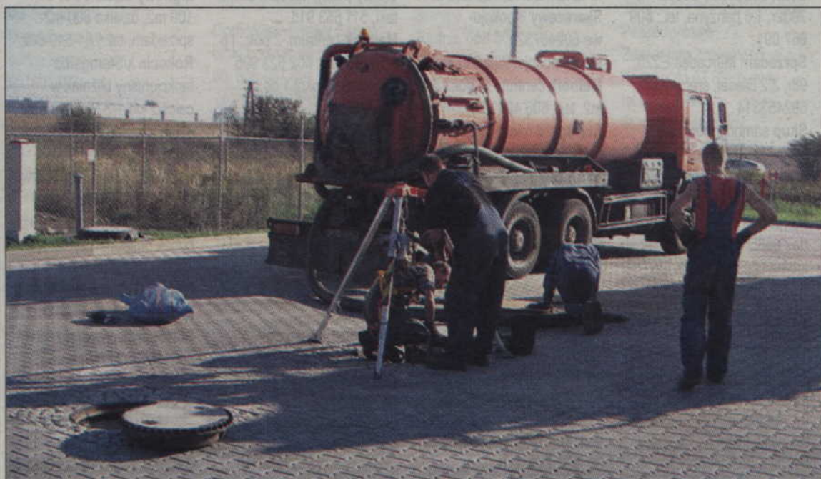
Separatory znajdujące się m.in. na stacjach paliw muszą być regularnie czyszczone, by mogły spełniać swoją funkcję.
