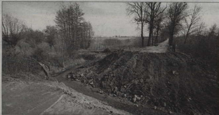
Droga na odcinku Bądkki-Wandowo zapadła się w ubiegłym tygodniu. Jej naprawa pochłonie blisko 400 tys. zł.
