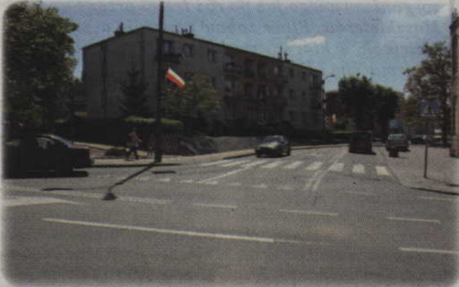
Przebudowane zostało skrzyżowanie ulic 15 Sierpnia i Warszawskiej. Kierowcy mogą korzystać z dodatkowego pasa ruchu.
