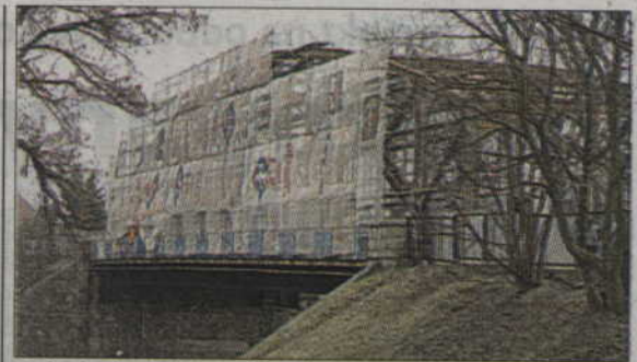
Modernizacja wiaduktu na dwa miesiące wyłączyła ten przejazd na drugą stronę miasta. Fot. Mirosław Wiśniewski
