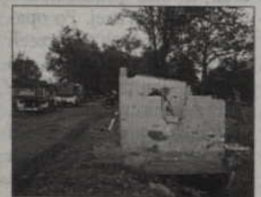
Uszkodzona została również wiat przystanku autobusowego.
