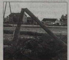
Tornado złamało m.in. słupy oświetleniowe i słupy elektryczne.
