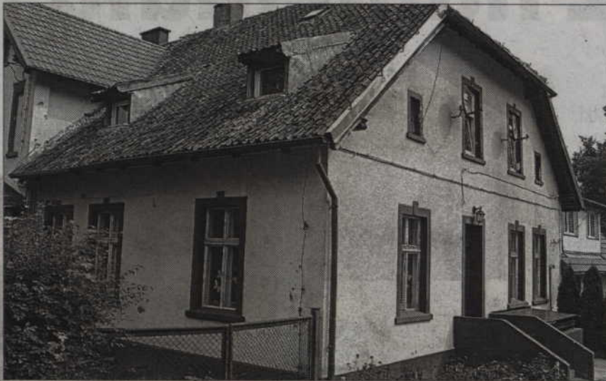
30 tys. zł będzie kosztowała gardejski samorząd naprawa dachu na budynku w którym mieści się świetlica wiejska w Nowej Wiosce.
