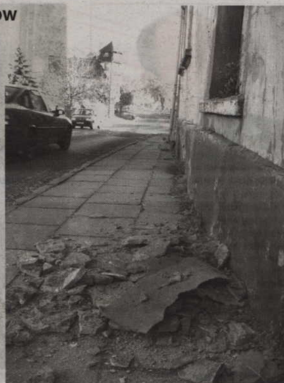
Tynk odpadający od kamienicy przy ul. Kwidzyńskiej 18 stanowi zagrożenie dla przechodniów.
