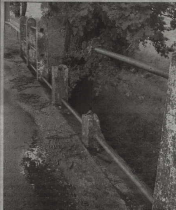
Zniszczona balustrada wiaduktu w Krzykosach ma zostać naprawiona jeszcze w tym miesiącu.
