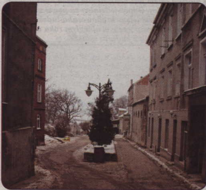
Wspólnoty czterech kamienic przy ul. Zamkowa Góra wystąpiły do wojewódzkiego konserwatora zabytków z wnioskiem o wpisanie budynków do rejestru zabytków. Stan techniczny elewacji jest bardzo zły, ale samorząd nie może przeznaczyć na remont pieniędzy z budżetu, gdyż budynki nie są własnością miasta.
