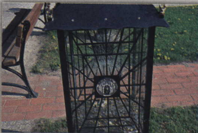
Skarbonka zniszczona przez prabuckich wandalów.
