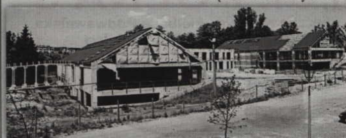
Trwa budowa infrastruktury Kwidzyńskiego Parku Przemysłowo-Technologicznego z Centrum Energii Odnawialnej w Górkach.
