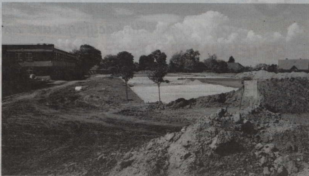
Przy Szkole Podstawowej nr 4 powstaje kompleks boisk. To pierwszy etap z zaplanowanych prac. W przyszłym roku ma powstać między innymi bieżnia.
