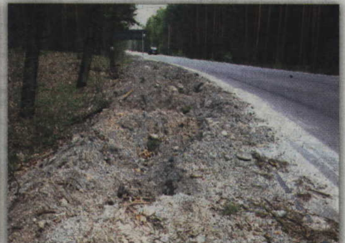
Pobocze wyremontowanego odcinka przy drodze Sadlinki - Gardeja jest niszczone przez dziki. Fot. Ryszard Bartosiak
