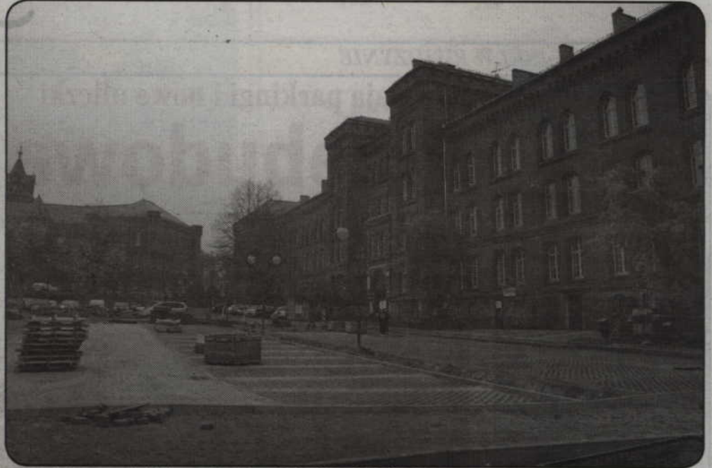
Trwa przebudowa terenu po byłej jednostce wojskowej przy ulicach 11 Listopada i Grudziądzkiej.
