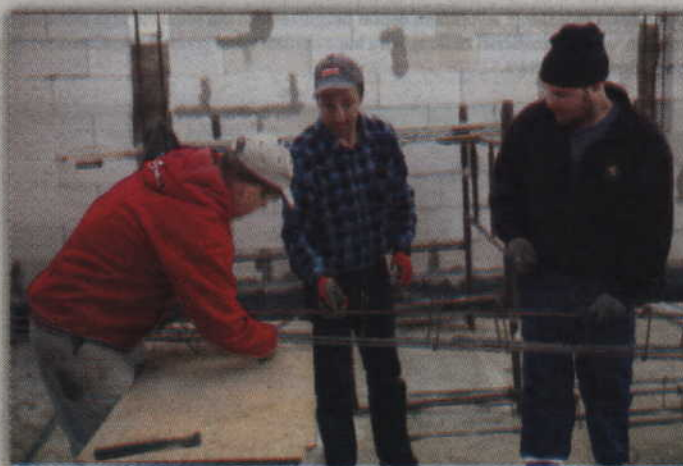
Do wykonania zbrojenia wykorzystano stal ze słupów energetycznych. Na zdjęciu, od lewej: Bogusław Pajewski, Zbigniew Klimek i Rafał Pomarański.
