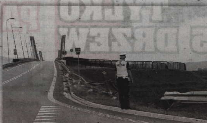
Kierowca zniszczył bariery znajdujące się przy wjeździe na most w Lipiankach.
