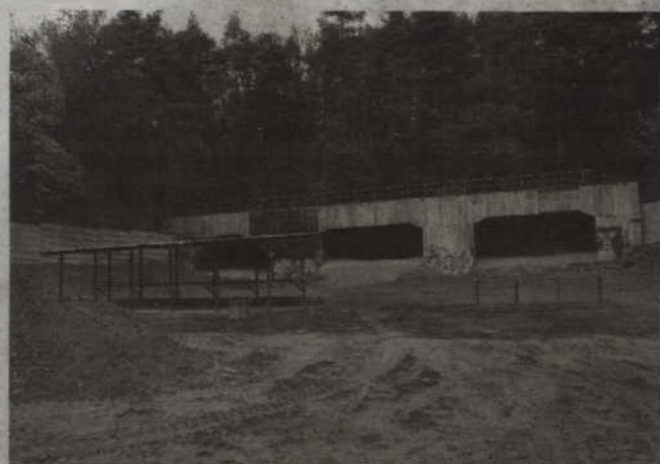
Do końca listopada powinna zakończyć się przebudowa strzelnicy miejskiej przy ul. Strumykowej.
