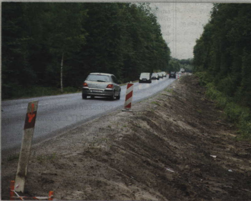
Prace drogowe rozpoczęły się na leśnym odcinku drogi wojewódzkiej nr 521 pomiędzy Liczem a Raniewem.
