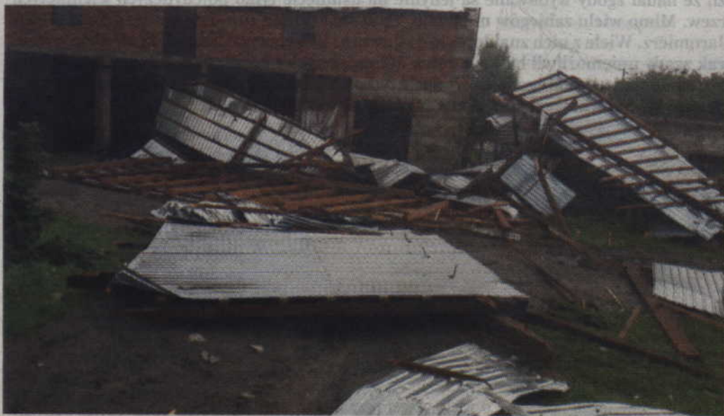
Porywisty wiatr zerwał dach z budynku gospodarczego.
