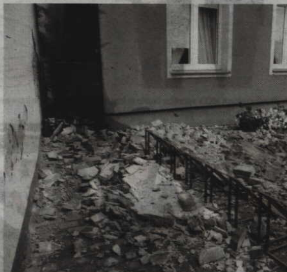
Na plac przed urzędem gminy runęła część ściany
