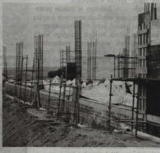
Pod naporem wiatru nie wytrzymała ściana budowanego pawilonu handlowego przy ul. Malborskiej.
