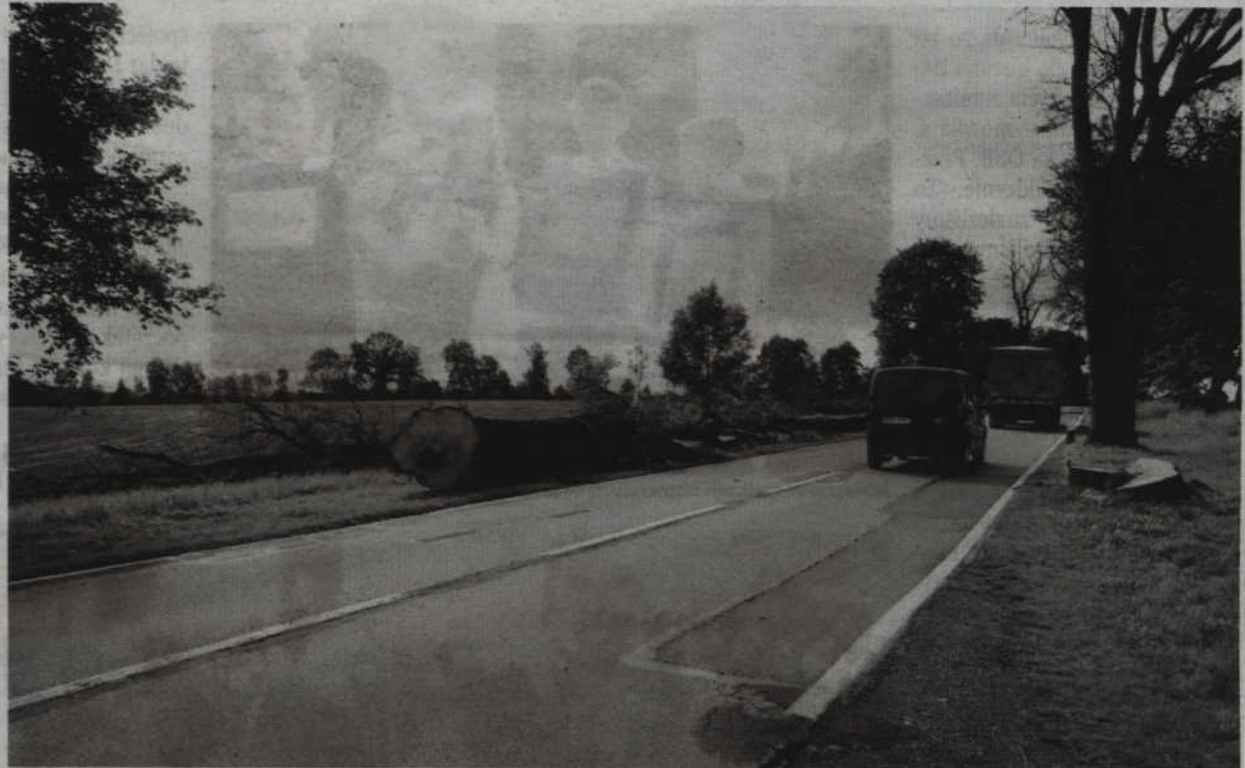
(RB) W kilku miejscach na usunięto już drzewa. Za kilka tygodni powstaną tam zatoczki autobusowe.
