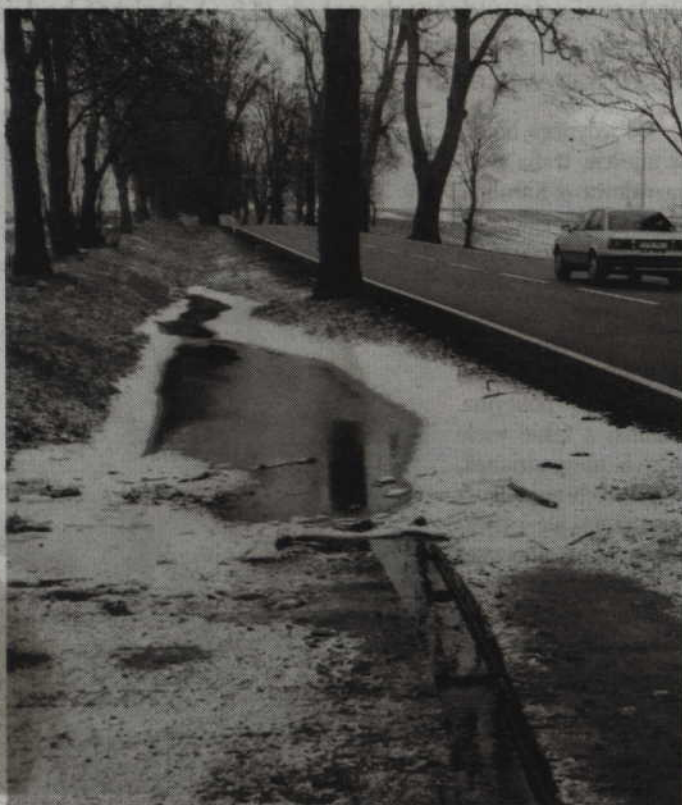
Drogowcy w asfaltowym zjeździe wykonali niewielki kanał dzięki któremu woda swobodnie odpływa z rowu i nie zagraża kierowcom. Fot. Ryszard Bartosiak
