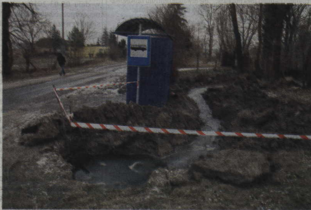
Przy ciekącym hydrancie wykopano rów w ziemi, aby woda mogła swobodnie płynąć sobie dalej.
