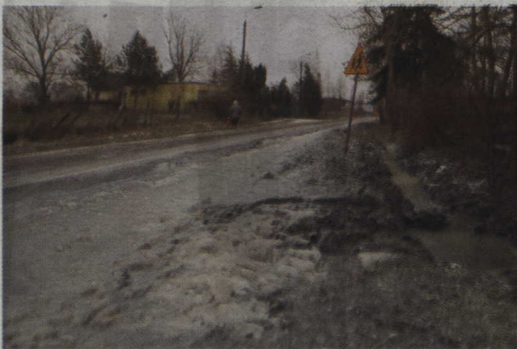
Zamrznięta woda z uszkodzonego wodociągu zagraża nie tylko pieszym ale również kierowcom.
