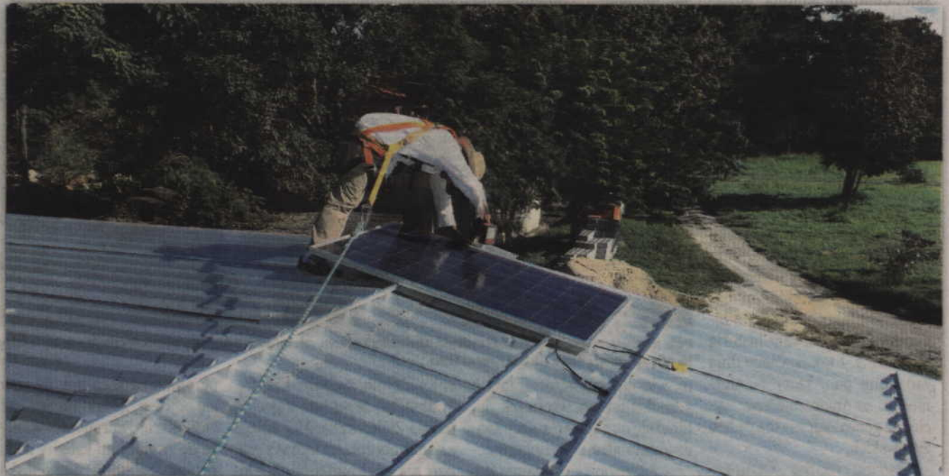
Na terenie gmin Kwidzyn, Sadlinki, Ryjewo oraz Gardeja m.in. kolektory słoneczne i pompy ciepła.
