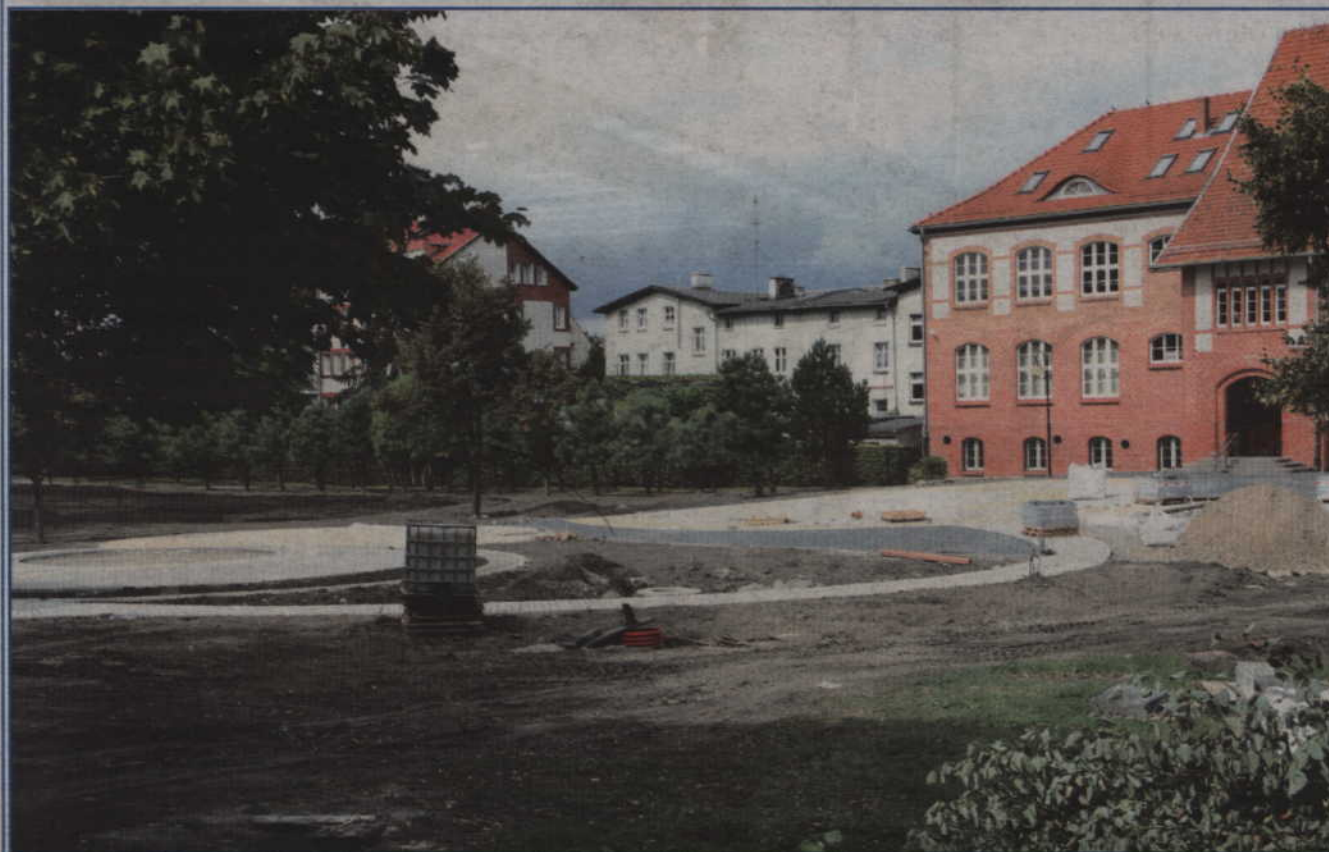
Trwają prace przed budynkiem Szkoły Podstawowej nr 2. To pierwszy etap prac polegający na zagospodarowaniu dziedzińca.
