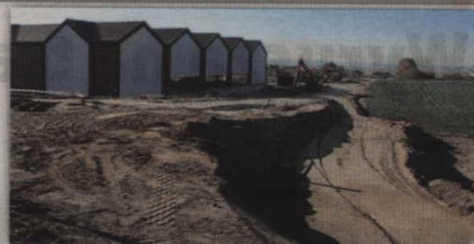
Z powodu różnic poziomów wykonawca musiał nawieźć sporo piasku, aby można było zacząć budowę ulicy
