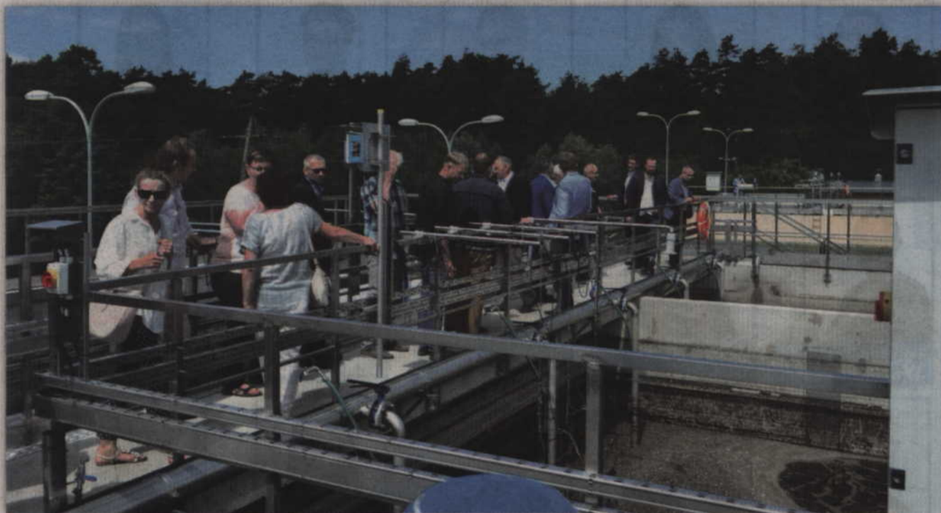
Gmina Ryjewo odprowadza swoje ścieki do zmodernizowanej oczyszczalni w Matowskich Pastwiskach. Fot. archiwum UG Ryjewo
