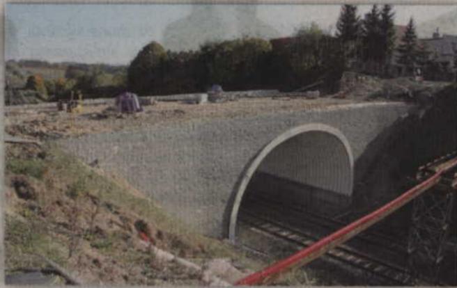
W niedzielę, 21 października, mieszkańcy będą mogli przejść na drugą stronę po budowanym moście na ul. Owczej. Umożliwi to specjalna kładka. Fot. Jacek Kluczkowski
