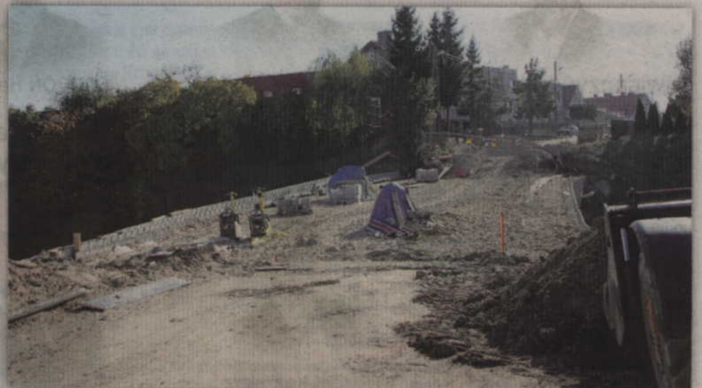
Wiadukt będzie miał 45 metrów długości. Nie zbraknie chodnika i ścieżki dla rowerzystów. Fot. Jacek Kluczkowski
