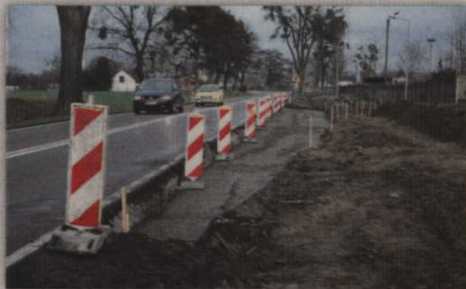
W Kalmuzach (gm. Gardeja) drogowcy wybudują zatoczki autobusowe, a także powstaną kilkusetmetrowy chodnik. Fot. Ryszard Bartosiak
