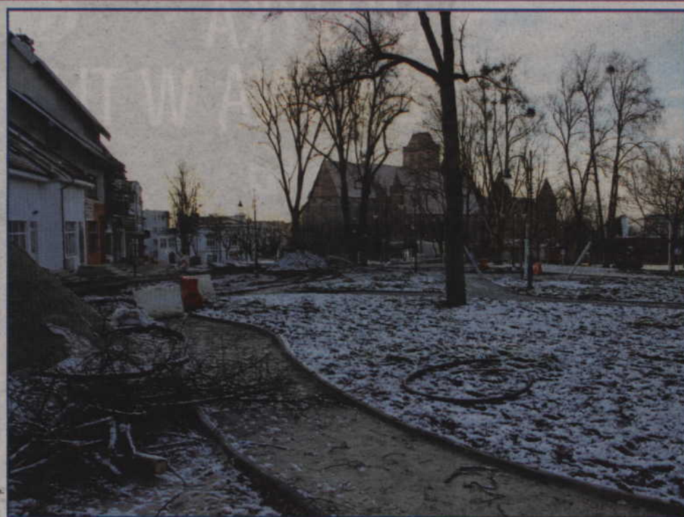
Przebudowę parku zajmuje się firma Krajobraz i Ogród z Baldramu. Na jego terenie powstaną ciągi piesze, elementy małej architektury i oświetlenie.
