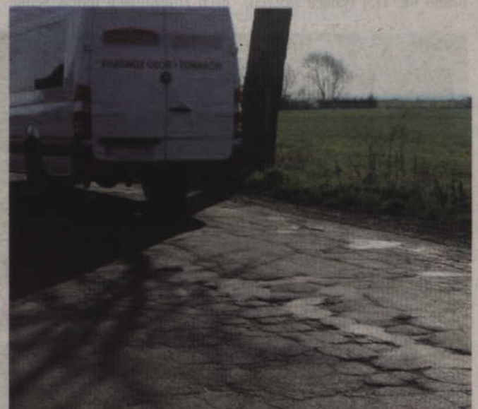
Jak co roku, po zimie pojawiły się kolejne dziury, które już niedługo zostaną załatane asfaltem.
