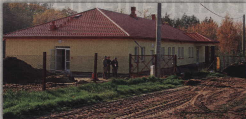
Dobiega końca budowa Centrum Integracji i Rehabilitacji Osób Niepełnosprawnych wraz z Warsztatem Terapii Zajęciowej w Ryjewie.
