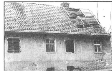
Budynek do remontu czy rozbiórki? Foto: J.K.
