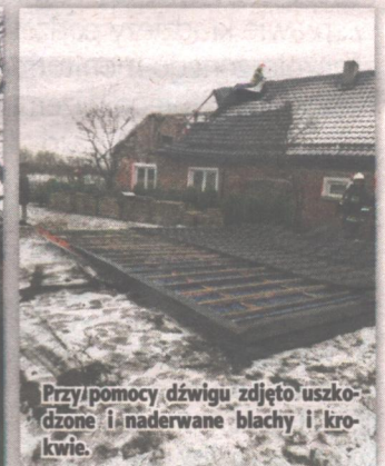
Silny wiatr zerwał dach z budynku mieszkalnego w Karpinach.
