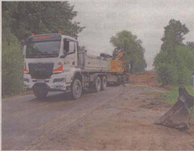
Trwa przebudowa drogi z Wandowa do Cygan na odcinku Wandowo-Rozajny w gminie Gardeja.
